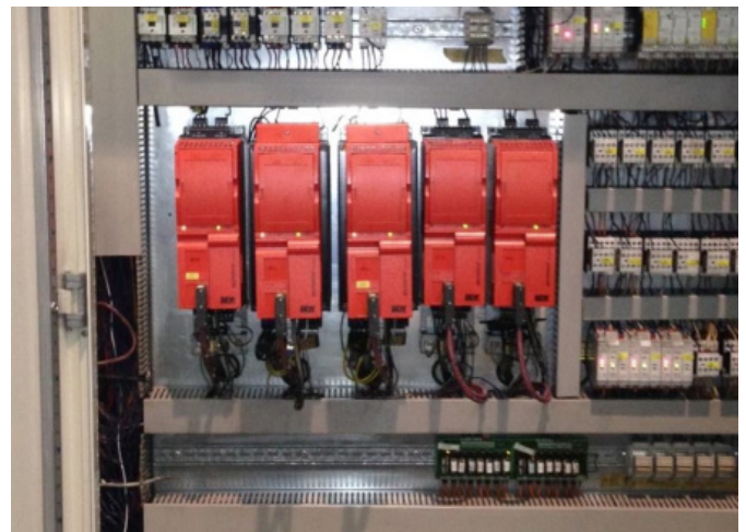
Stark verschmutzte Frequenzumrichter vor der Reinigung (oben). Die gereinigte Schaltanlage (unten) konnte den verlässlichen Betrieb der Verpackungsanlage wieder aufnehmen.
