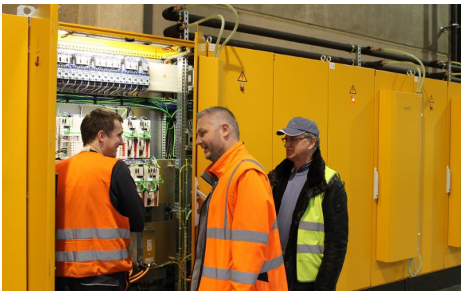
Lagebesprechung an einer neuen Schaltanlage: Frank Schmidt (Mitte) im Gespräch mit seinem Mitarbeiter Rico Koßmann (links) und Werner Hille (rechts).
