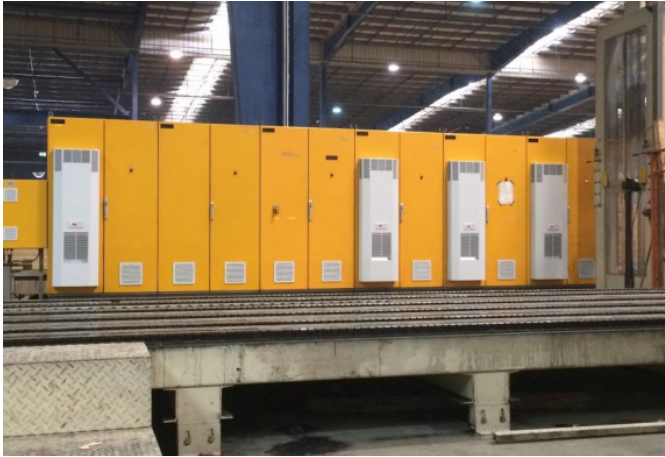
Die Schaltschränke der Verpackungsanlage nach der Umrüstung auf DTI-Kühlgeräte.
