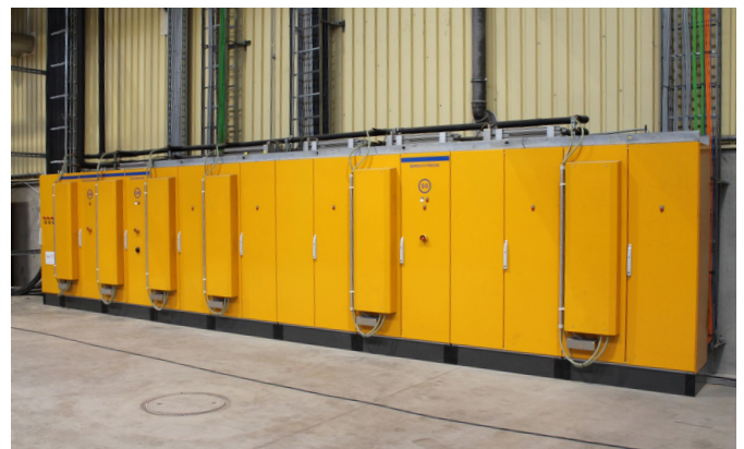
Neue Schaltanlage für eine Kurztaktpressen-Anlage zur Fußbodenfertigung ausgestattet mit Luft-/Wasser-Wärmetauschern von Pfannenberg.
